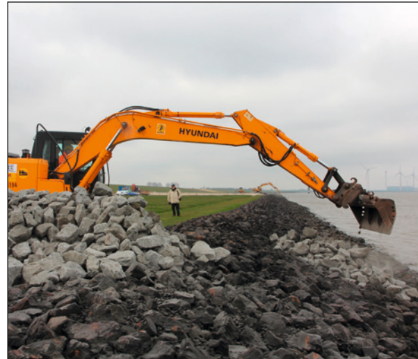
Verlust naturnaher Uferlebensräume durch Steinschüttungen
