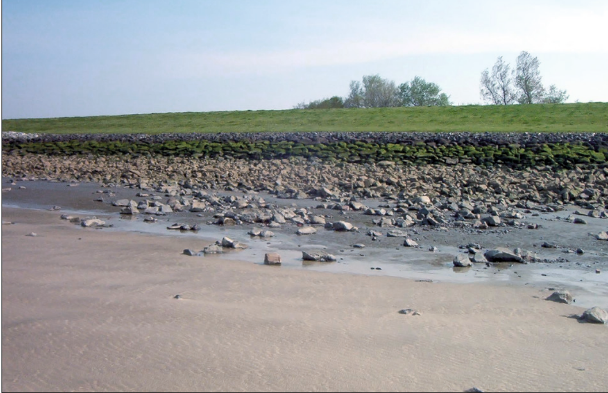
Schäden am Deckwerk im Altenbrucher Bogen an der Elbe
